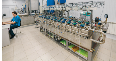
Метрологическая лаборатория оборудована проливными установками для поверки счетчиков воды и тепла Ду15-200
