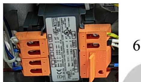
Трансформатор 12 в пер. тока для электронных плат
