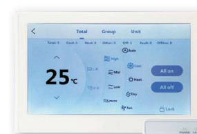
Центральный пульт управления QA-RPGC
