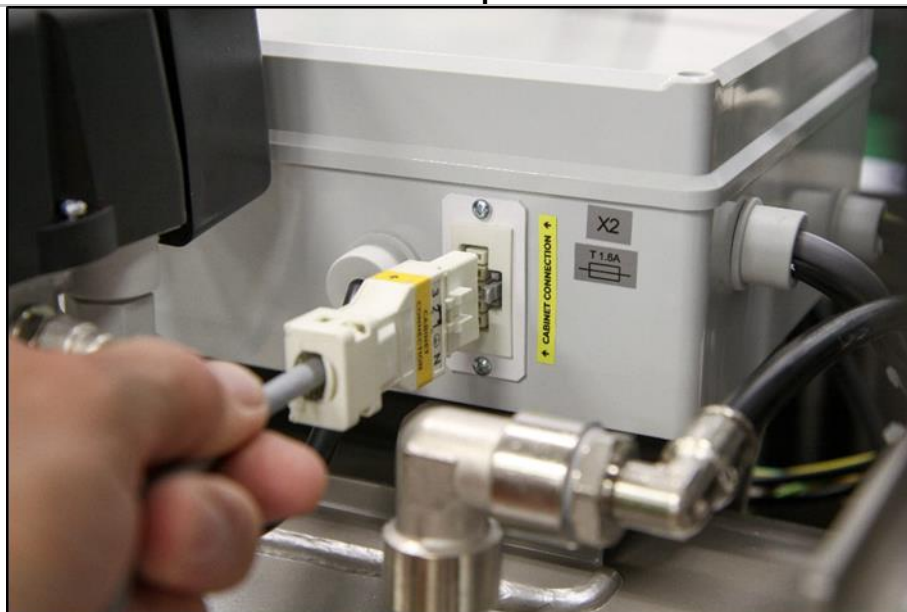
Fig. 18: Raccordement de l'armoire au compresseur
