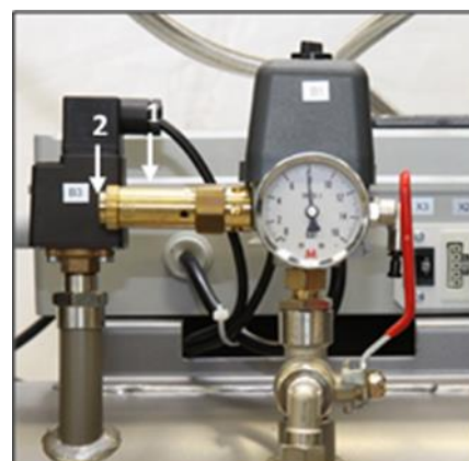
Рис. 22: Проверка предохранительного клапана
