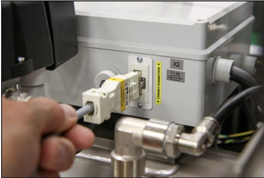
Рис. 18: Подключение шкафа к компрессору
