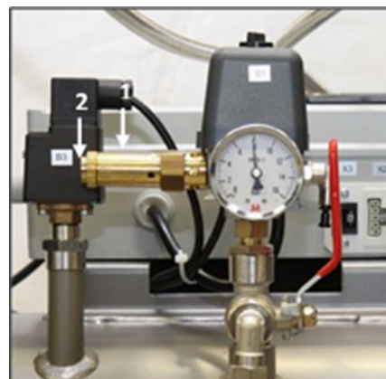
Fig. 22: Contrôle de la soupape de sécurité
