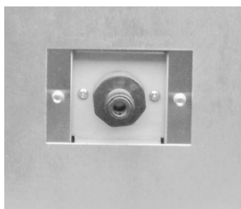
Рисунок 8 - водорозетка для внешнего водоснабжения.
